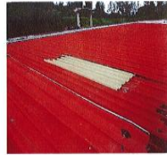
CUBIERTA ZONA COMEDOR-COCINA POR REVISAR
