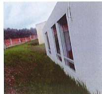
ANDENES Y CAÑUELA POR CONSTRUIR PARA EVITAR HUMEDAD Y LEVANTAMIENTO DE PISOS.
